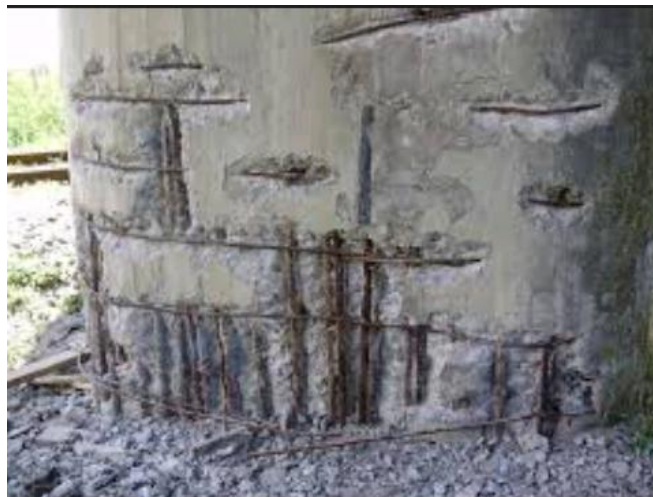
Рис. 1. Корозія залізобетонної конструкції
