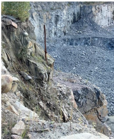
Рис. 3. Заклинена бурова штанга в шарі флювіогляціальних відкладів на кар'єрі Соснівського родовища гранітів
