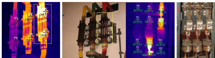
Рис. 2. Тепловізійні зображення перегріву елементів електромережі [2]
