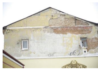
Рис. 2. Приклади порушення цілісності фасадів тріщинами (м. Житомир)
