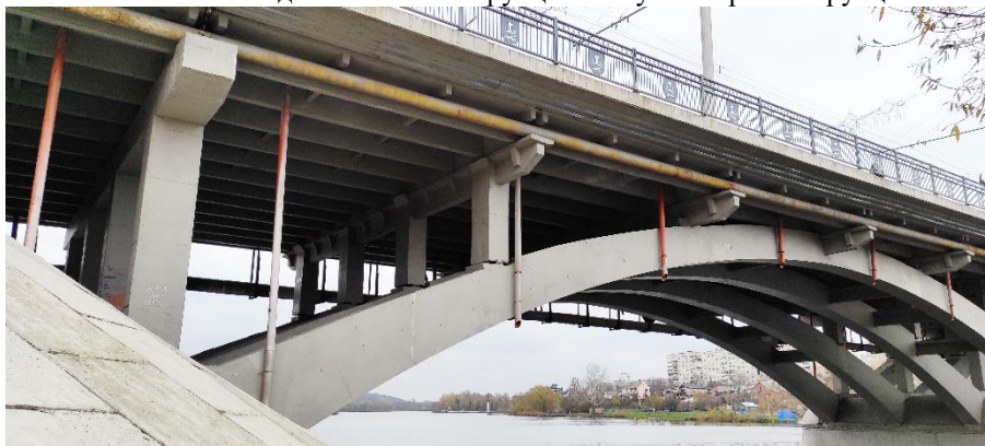
Рисунок 3 – Характерний стан залізобетонних конструкцій мосту після реконструкції (фото 18.18.2023 р.)
