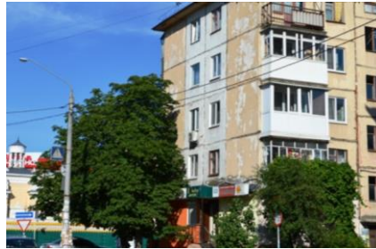
Рис.1. Приклад порушення візуальної цілісності фасаду будівель по вул. В. Бердичівська (м. Житомир)
