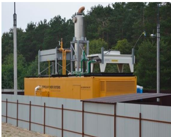
Рисунок 2 - Конегерційна установка ТОВ «ЛНК» на території Черкаського полігону ТПВ
